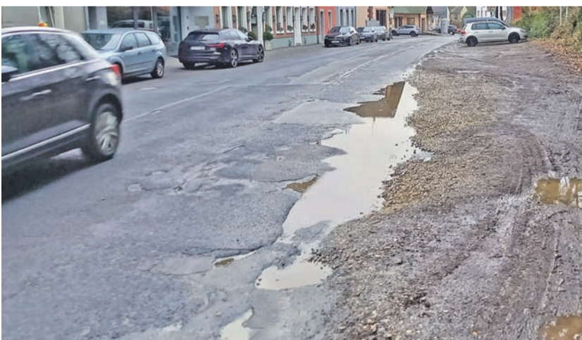
Buckelpiste. Die Schäden an der Ruwerer Straße sind offensichtlich: Schlaglöcher, beschädigte Bordsteine und das Wasser fließt nicht ab. In den nächsten Wochen wird die Straße umfassend saniert. Foto: StadtRaum Trier
